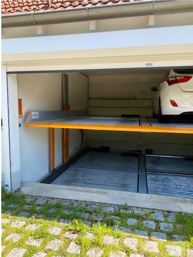
Hebebühne Duplex Garage unten
