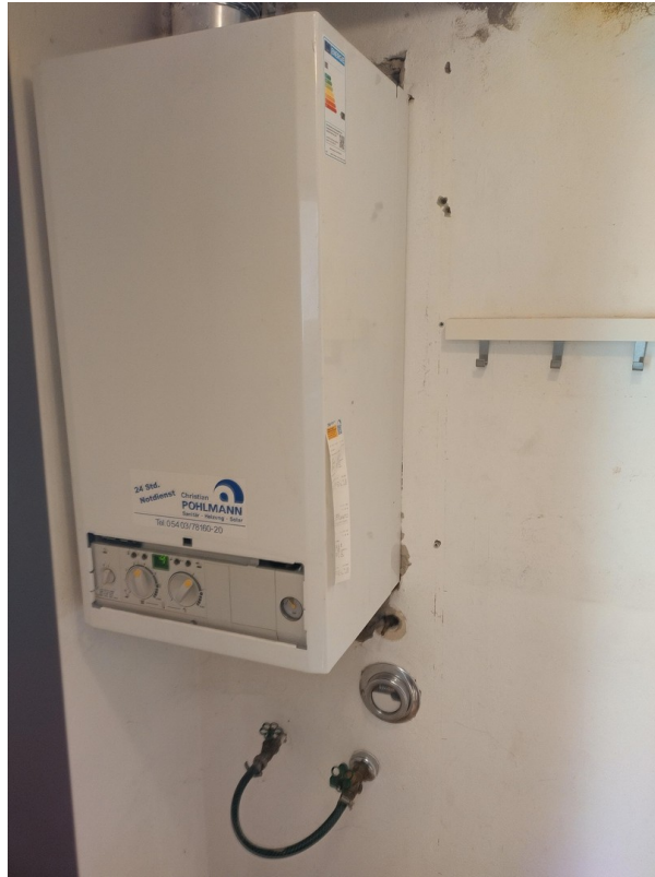
Therme im Abstellraum
