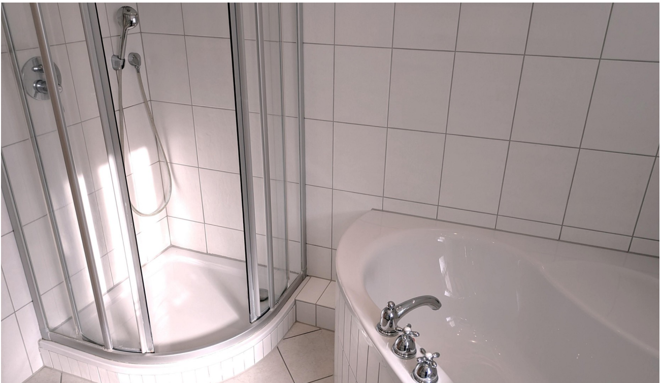
Bad OG Dusche
