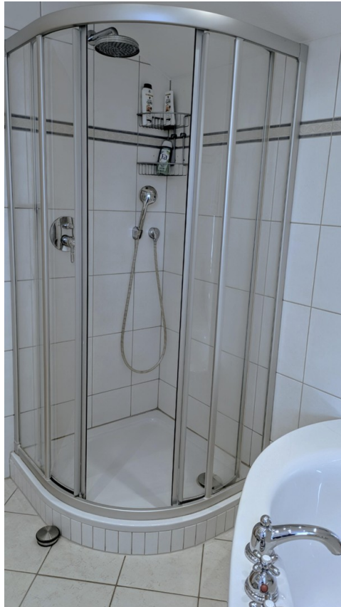
Bad OG Dusche
