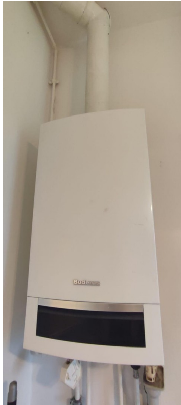
Gastherme mit Warmwasserbereit
