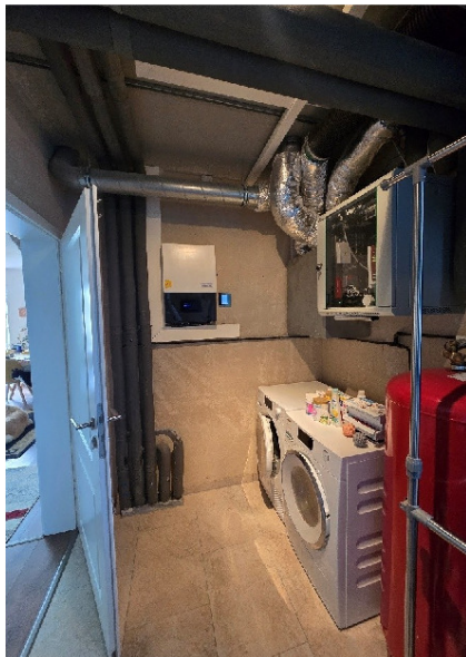
Hauswirtschaftsraum mit Anschluss für Waschmaschine und Trockner.
