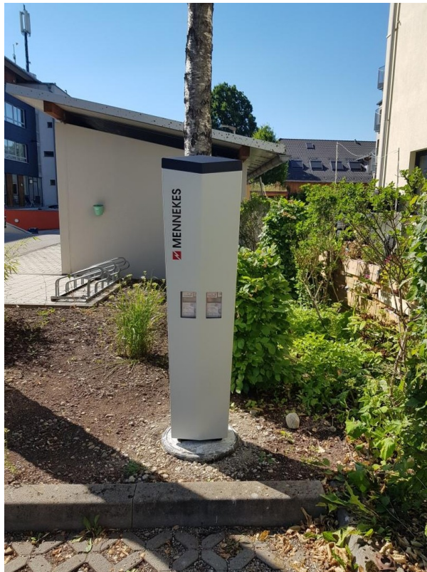
E.- Ladesäule 2x11KW
