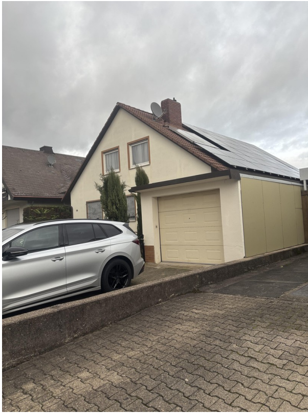
PV Anlage Haus Südseite
