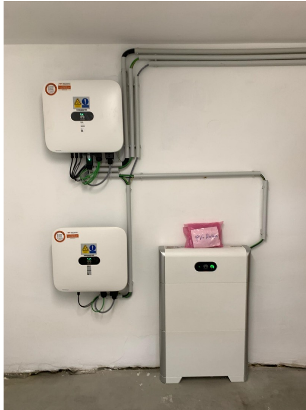
PV Anlage Technikraum Keller
