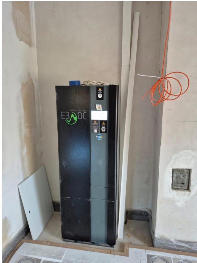
PV-Anlage inkl. Speicher
