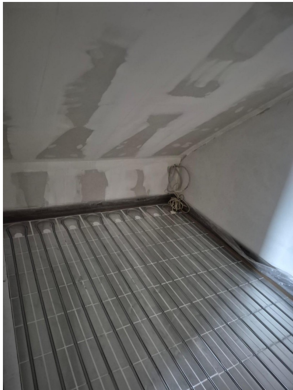
DG Wohnraum, Fußbodenheizung
