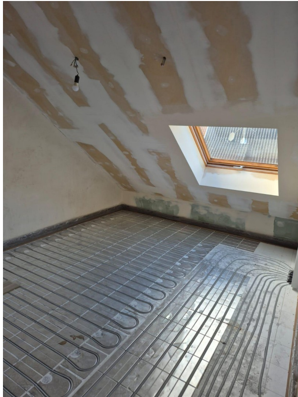
DG Wohnraum, Fußbodenheizung
