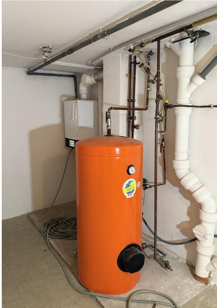
Heiztherme und Kessel
