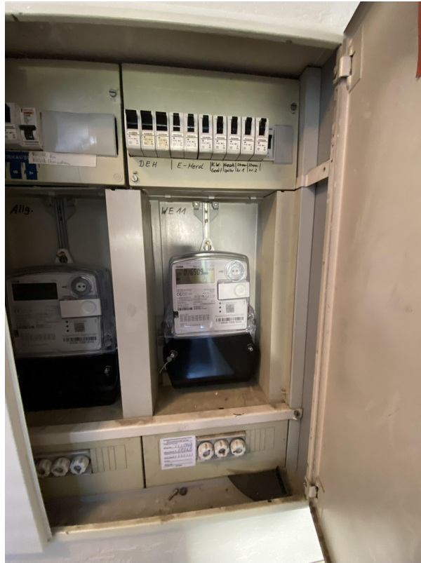
Stromzähler mit Absicherung
