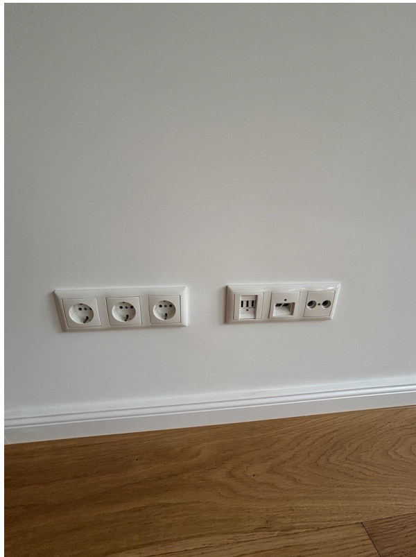
Anschlüsse in beiden Zimmern
