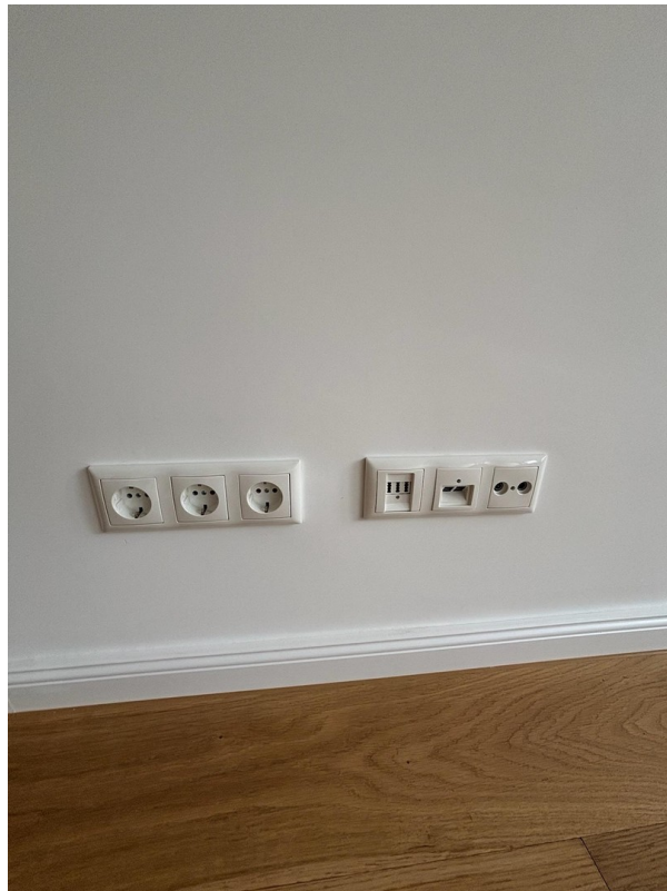
Anschlüsse in beiden Zimmern
