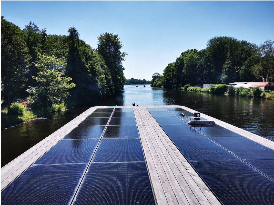
Solarpaneele auf dem Dach
