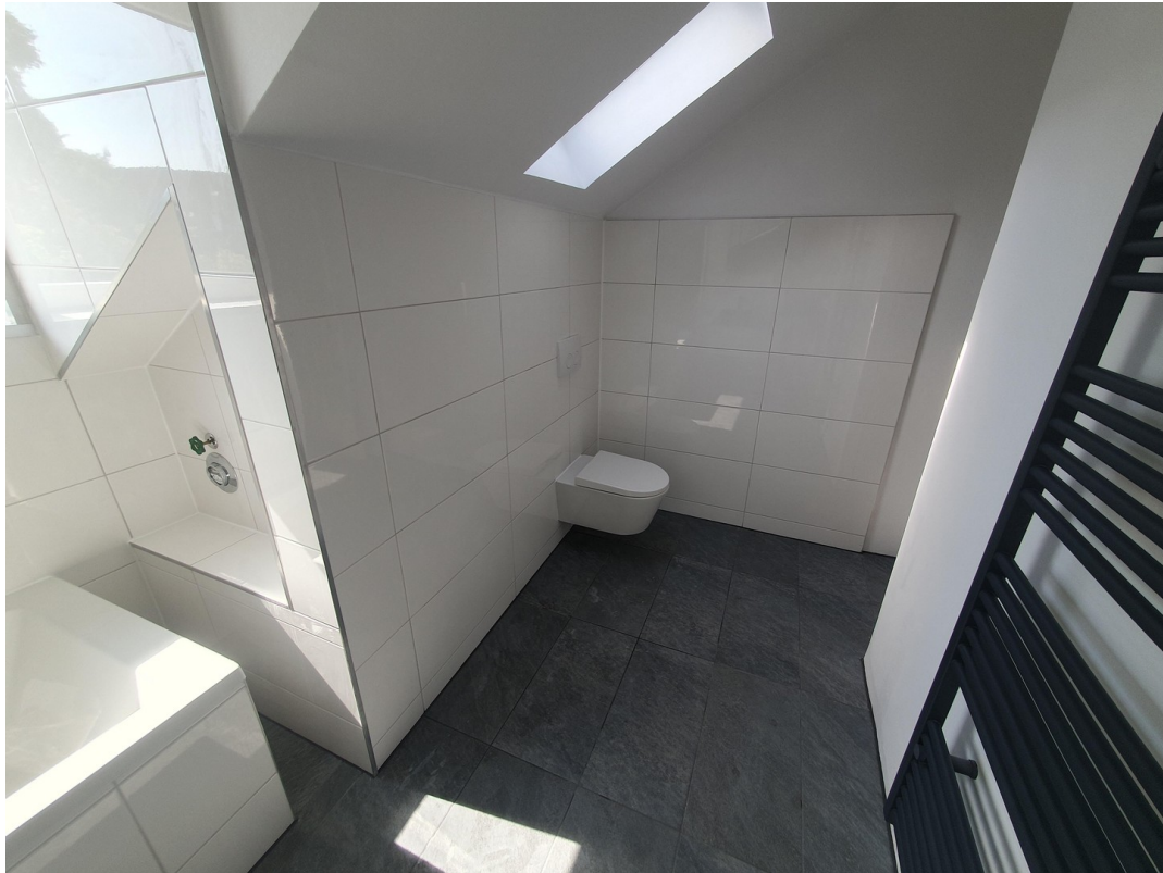
Bad Dachg. rechts
