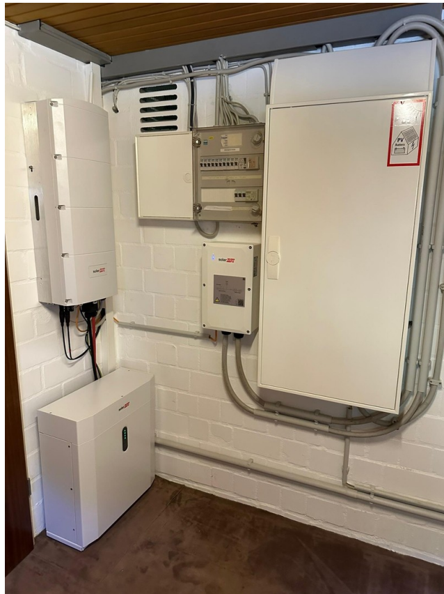
Wechselrichter und Backup PV
