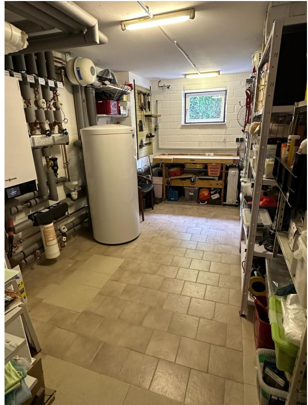
Heiz- und Werkbereich
