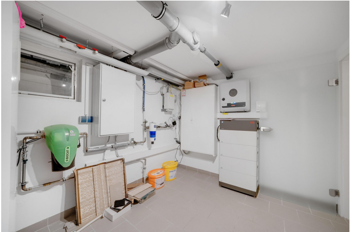
Technikraum , PV Anlage
