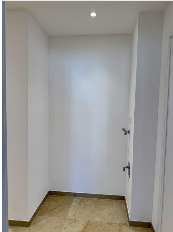
Flur - Anschluss WM + Trockner
