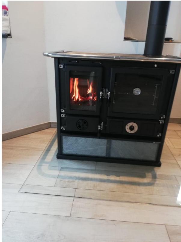
Wassergeführter Herd Neubau
