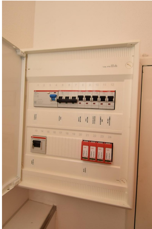
Elektro Verteilung NEU
