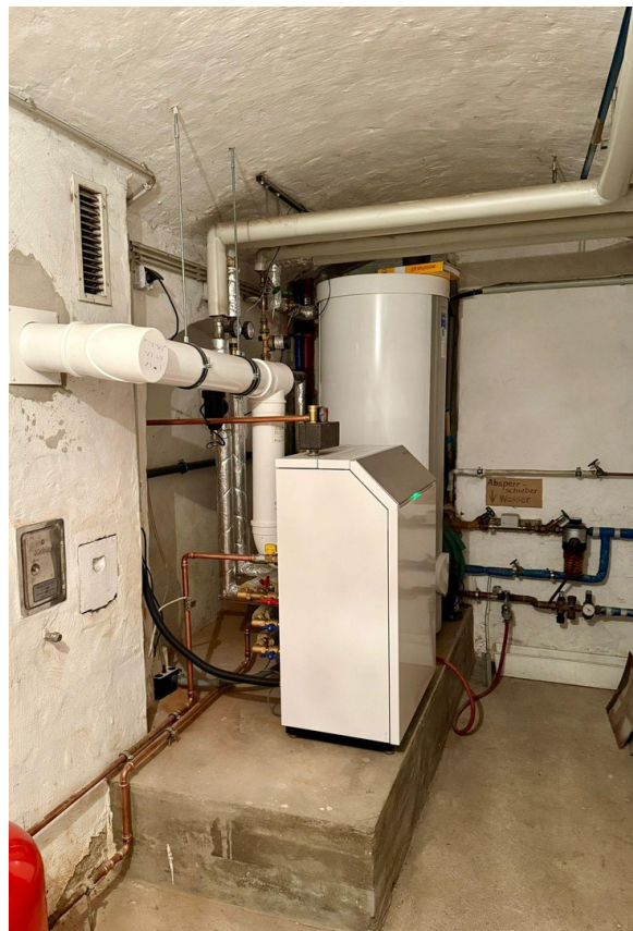
Brennwert Gas Heizung Bj. 2023
