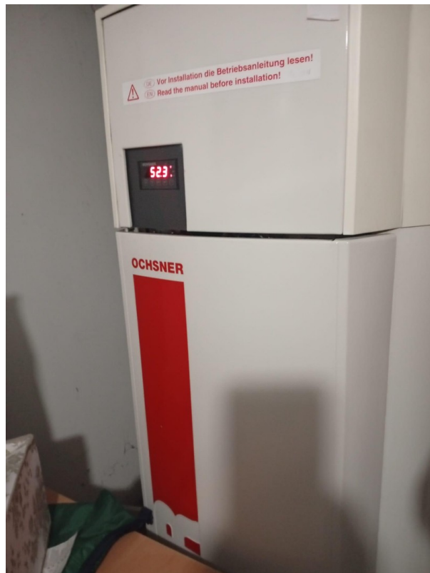
Wärmepumpe Ochsener Warmwasser
