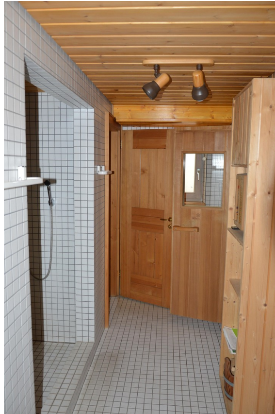
Saunabereich mit WC, gr.Dusche
