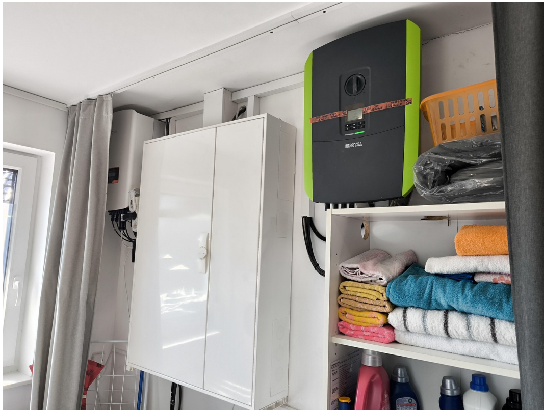
HWR Verteilung + PV Anlage
