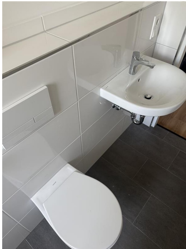
WC und Waschbecken
