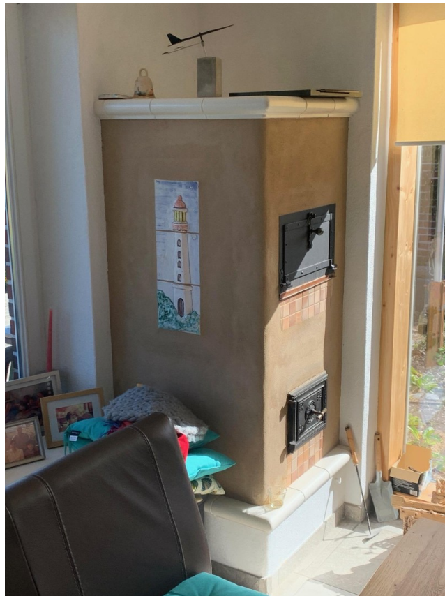
Grundofen im Anbau
