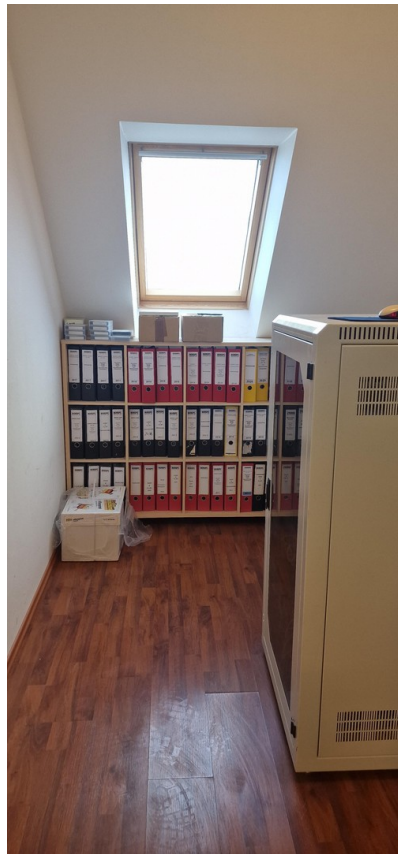
Serverraum im OG
