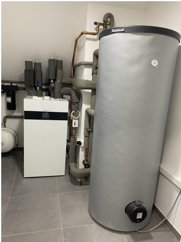
Wärmep. innen - Pufferspeicher
