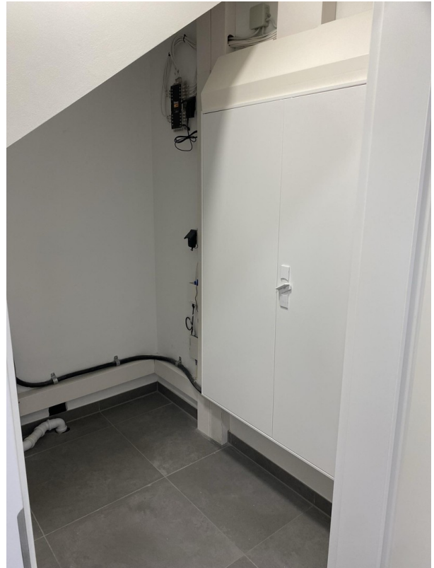
Technikraum - EG - Bild 2
