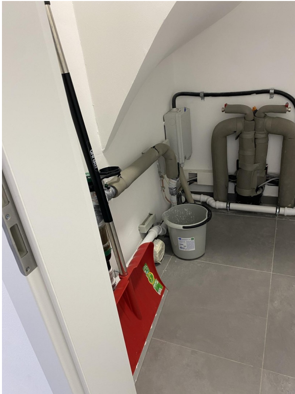
Technikraum - EG - Bild 1
