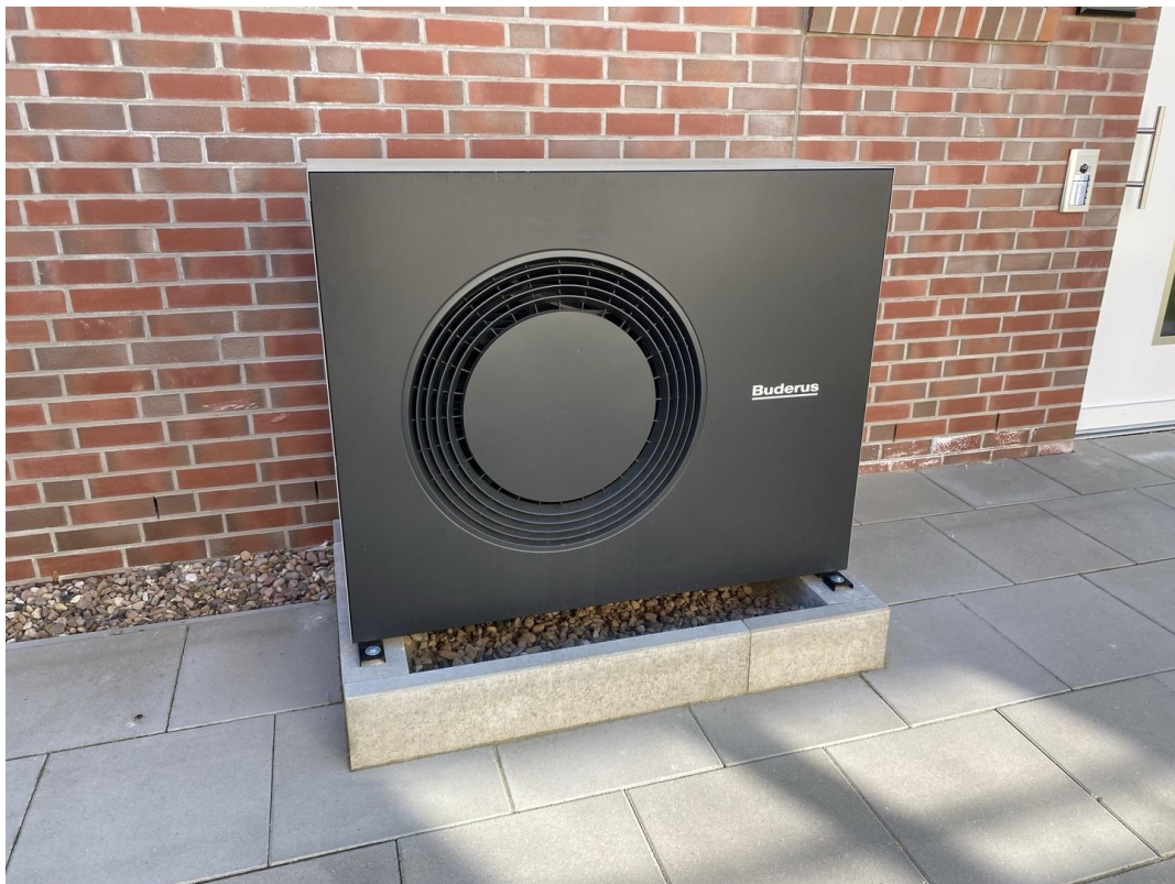
Außeneinheit der Wärmepumpe
