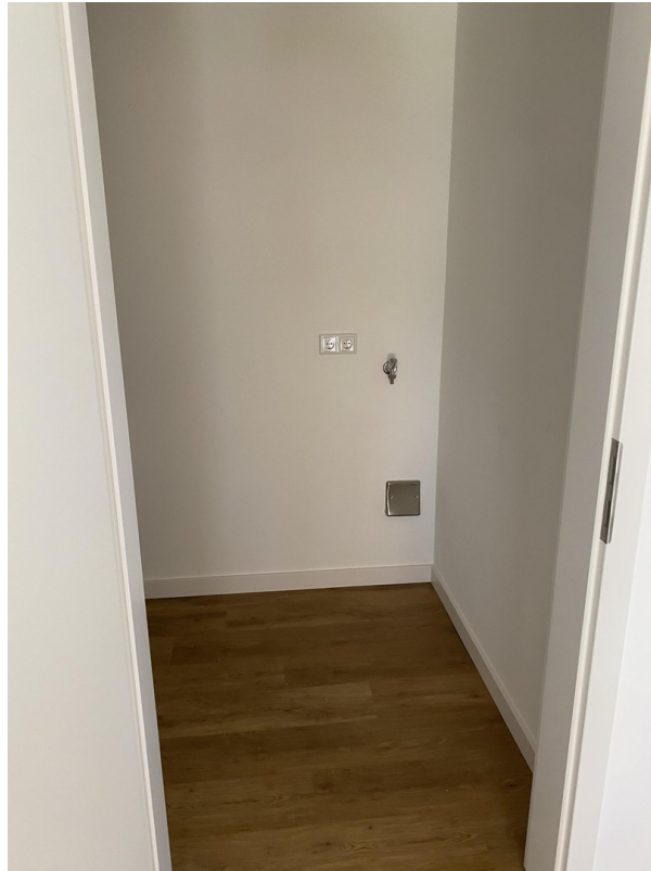
Abstellraum -Anschluss Waschm.
