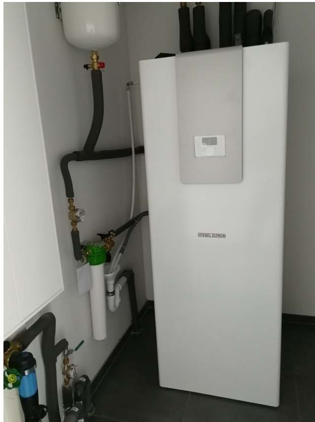
Technikraum u. Luft-Wärmepumpe
