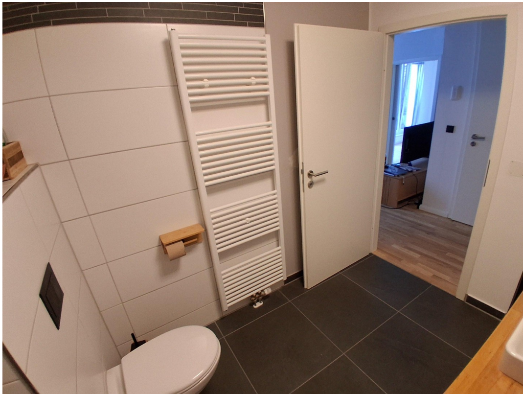
Bad mit Handtuch-Heizkörper
