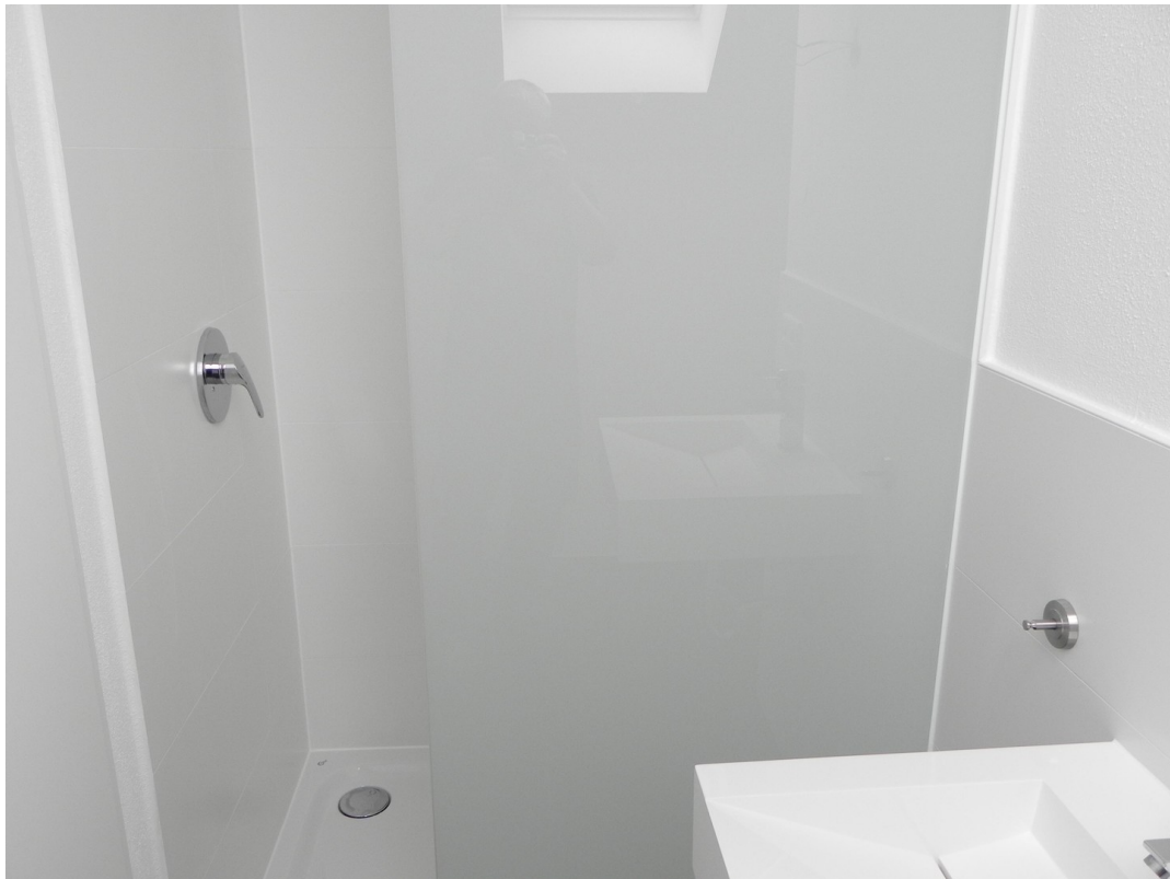
Dusche im DG
