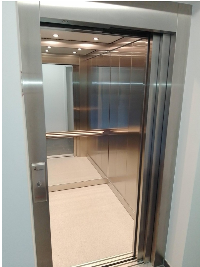
Aufzug zur Tiefgarage
