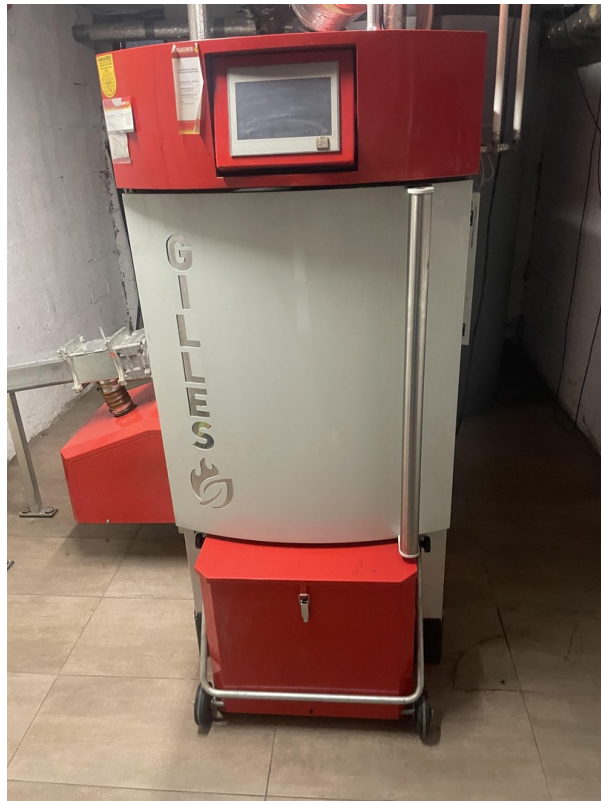
Heizraum mit zwei Speichern
