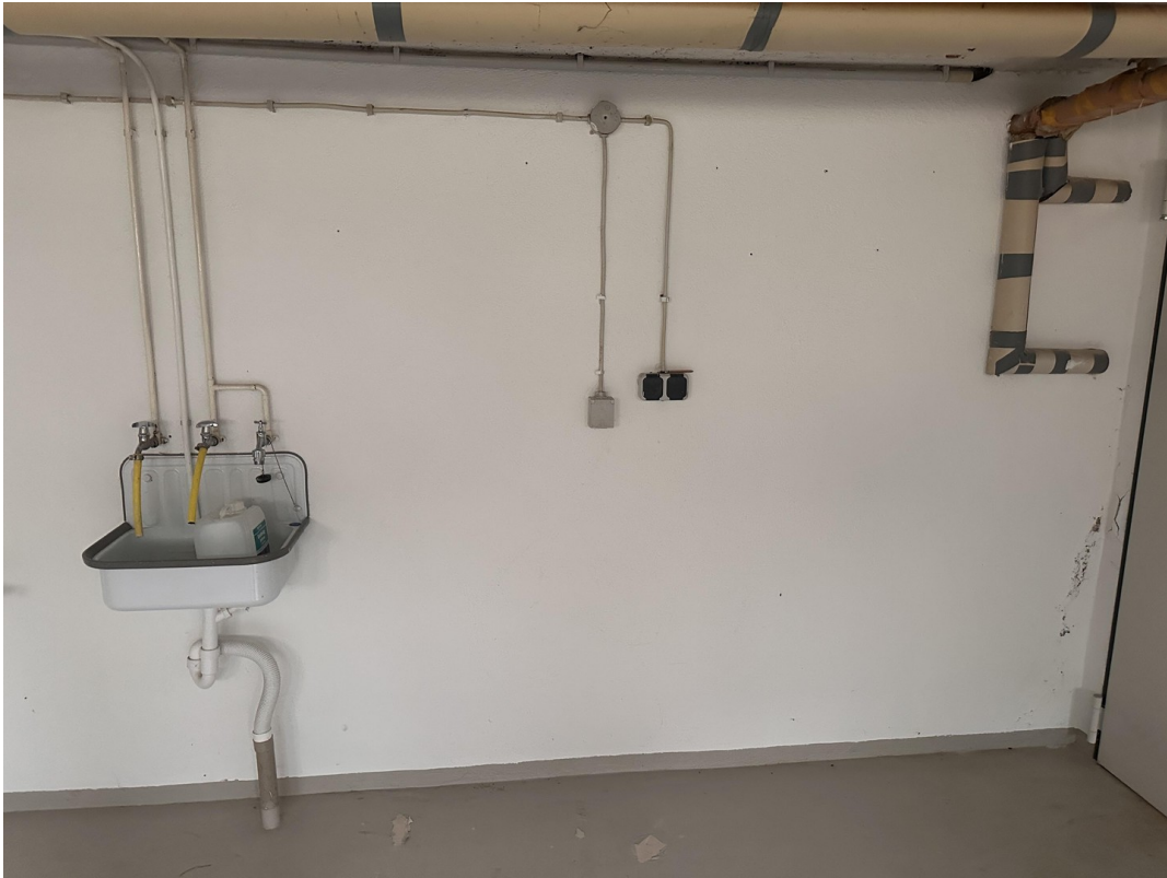
Anschlüsse Waschmaschine etc.
