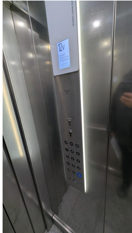
neue Aufzugsanlage von 2024
