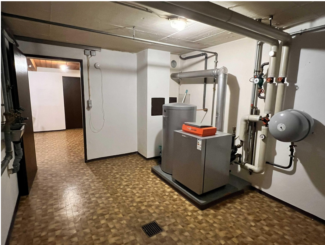
UG Heizungsraum und Waschküche
