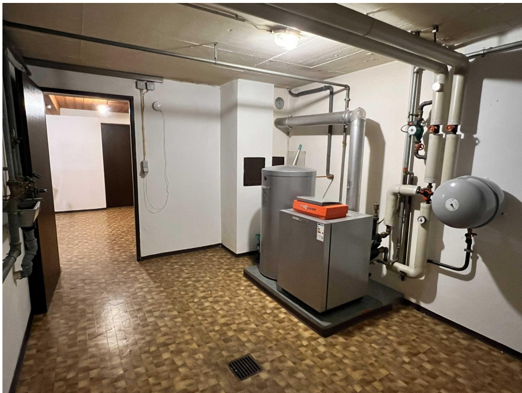
UG Heizungsraum und Waschküche
