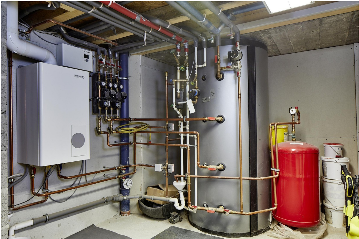
Heizung und Wasseraufbereitung
