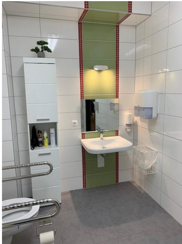
Hinterhaus sanitäre Anlagen
