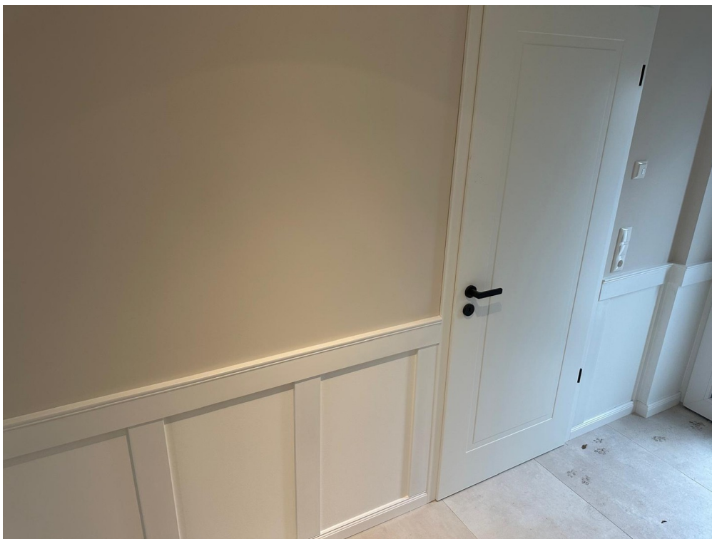
Wand im Flur
