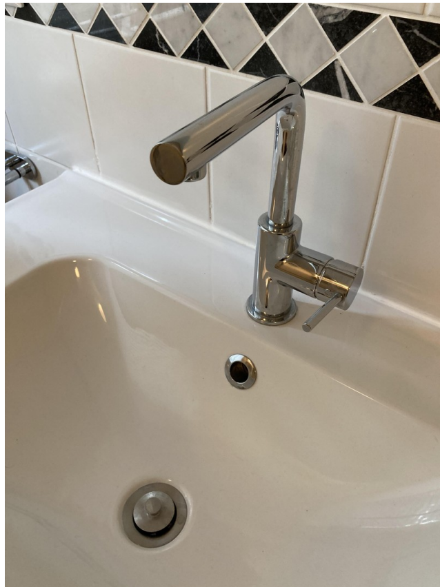
Armaturen im Bad
