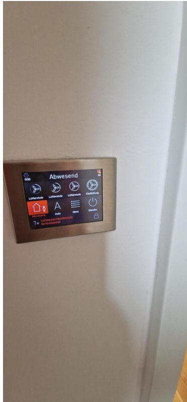
Lüftungsanlage mit Wärmerückg.
