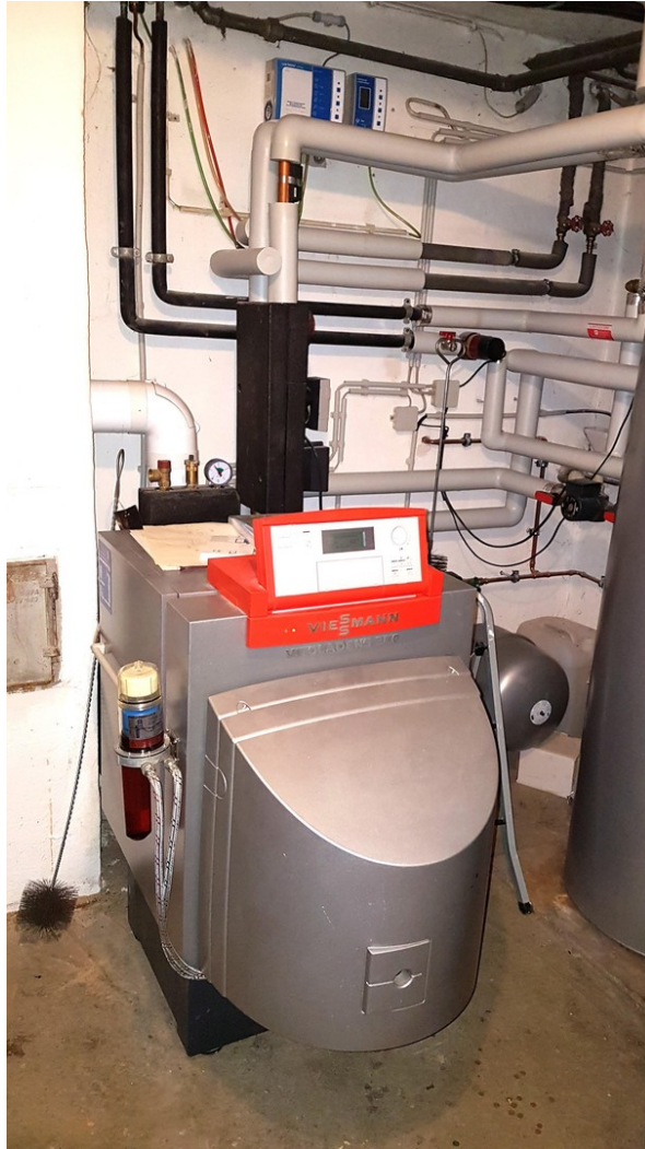
Heizungsraum im UG
