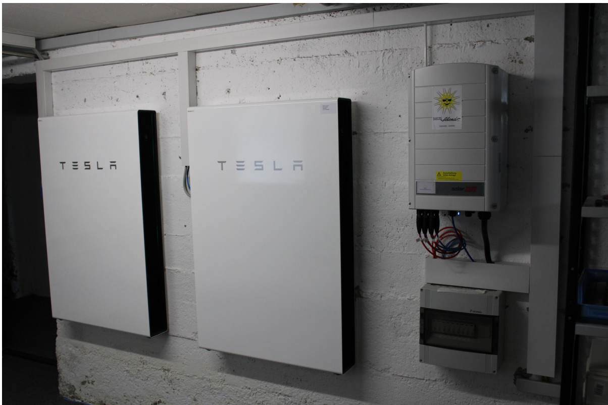
Tesla Speicher 27Kw
