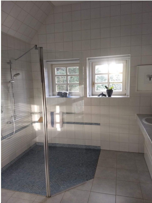
Bad, begehbare Dusche
