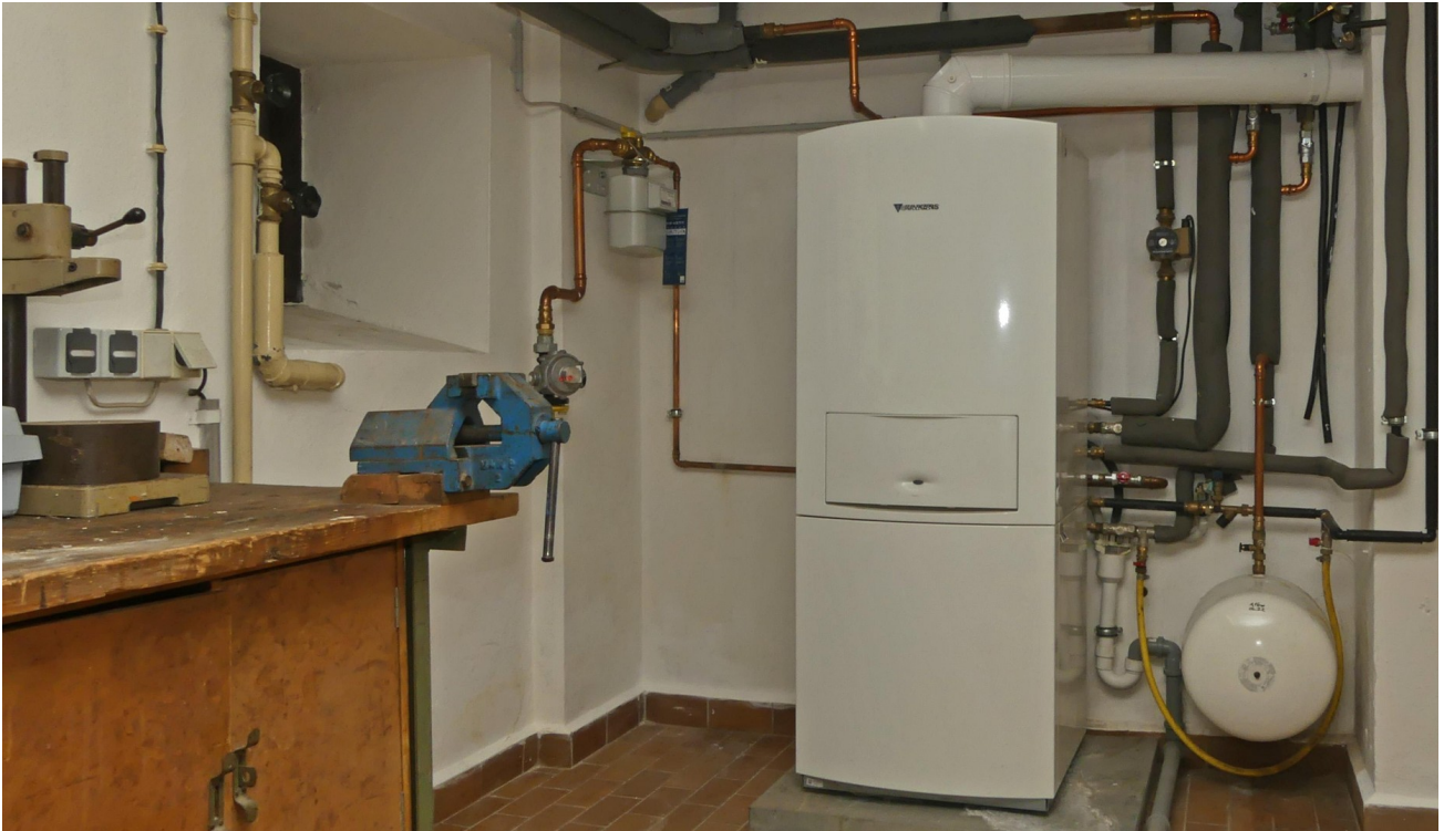
KG Moderne Heizung / Werkstatt
