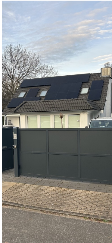
Dach-PV Anlage ca. 9 KW
