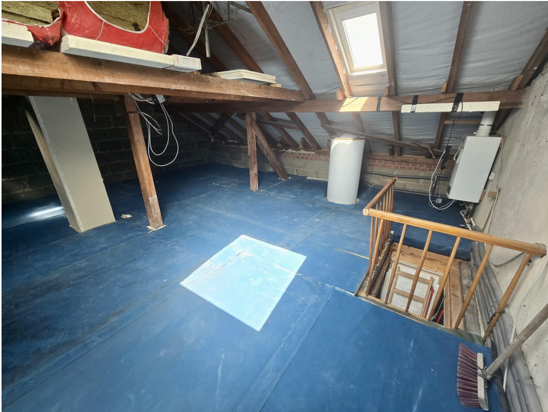
Dachboden mit Heizung-Warmwass
