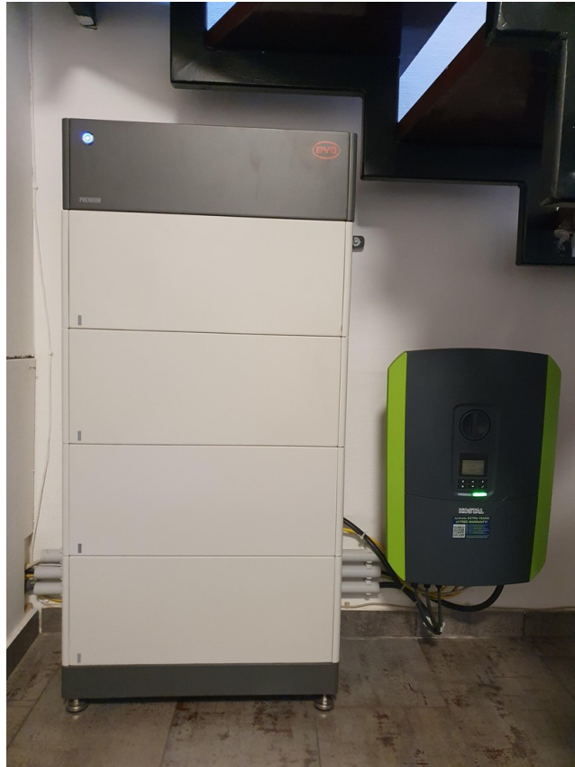
Speicher und Gleichrichter
