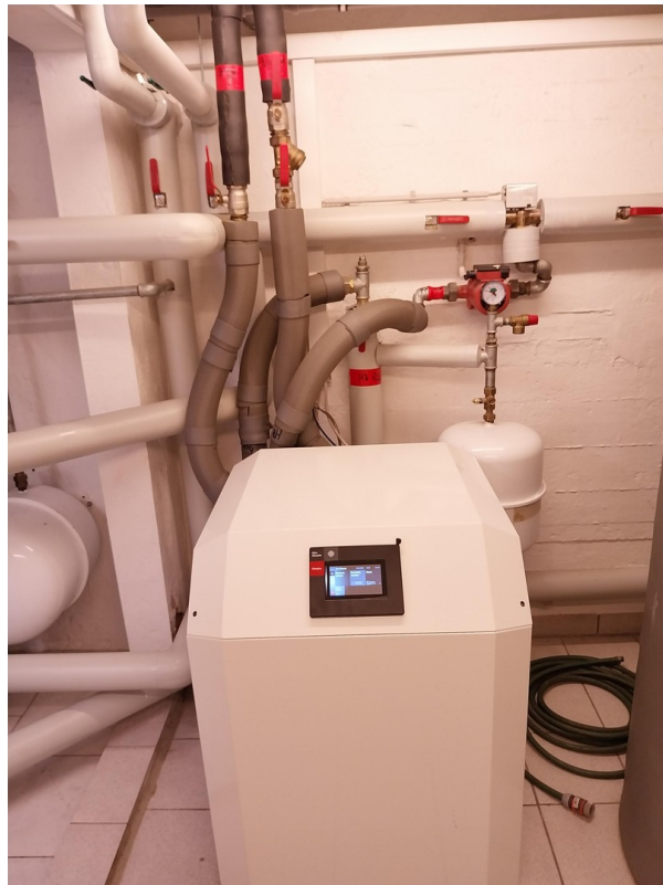
Wärmepumpe im Keller
