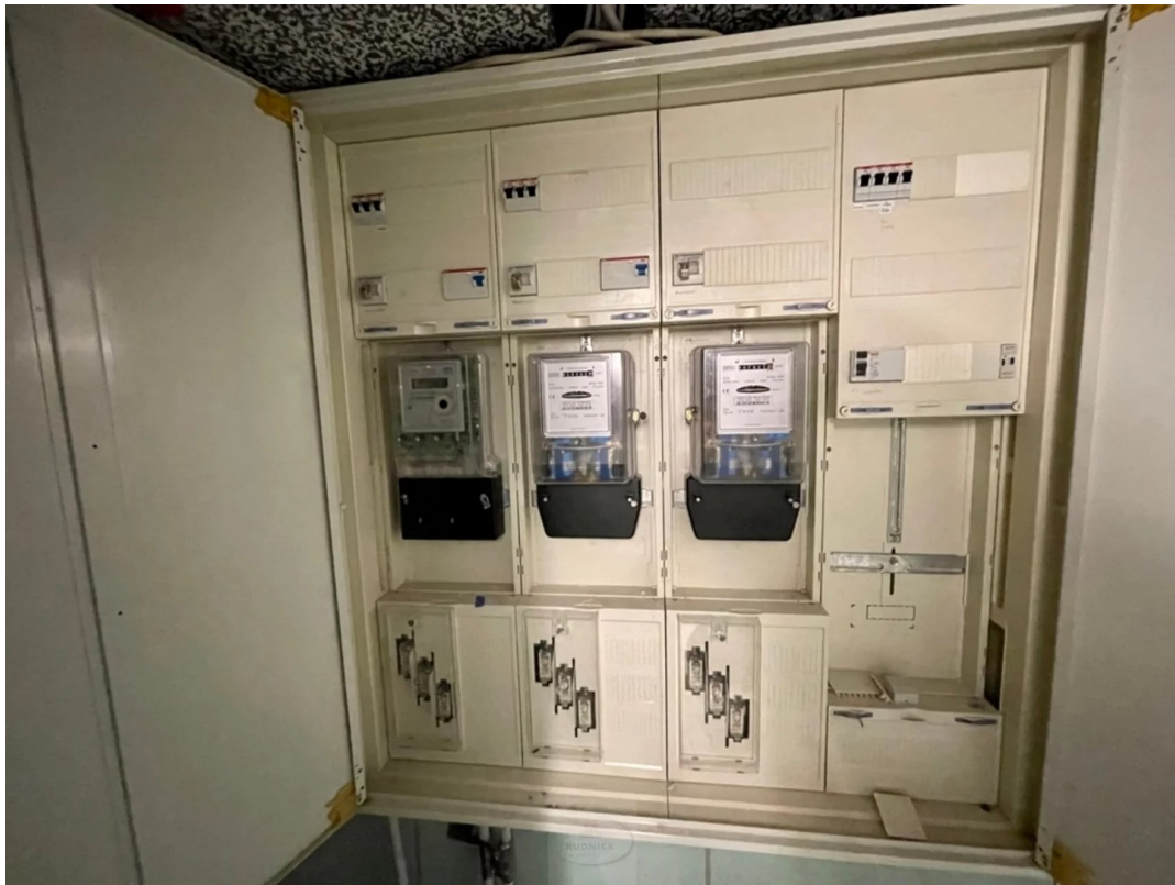
Schaltkasten Strom im Keller
