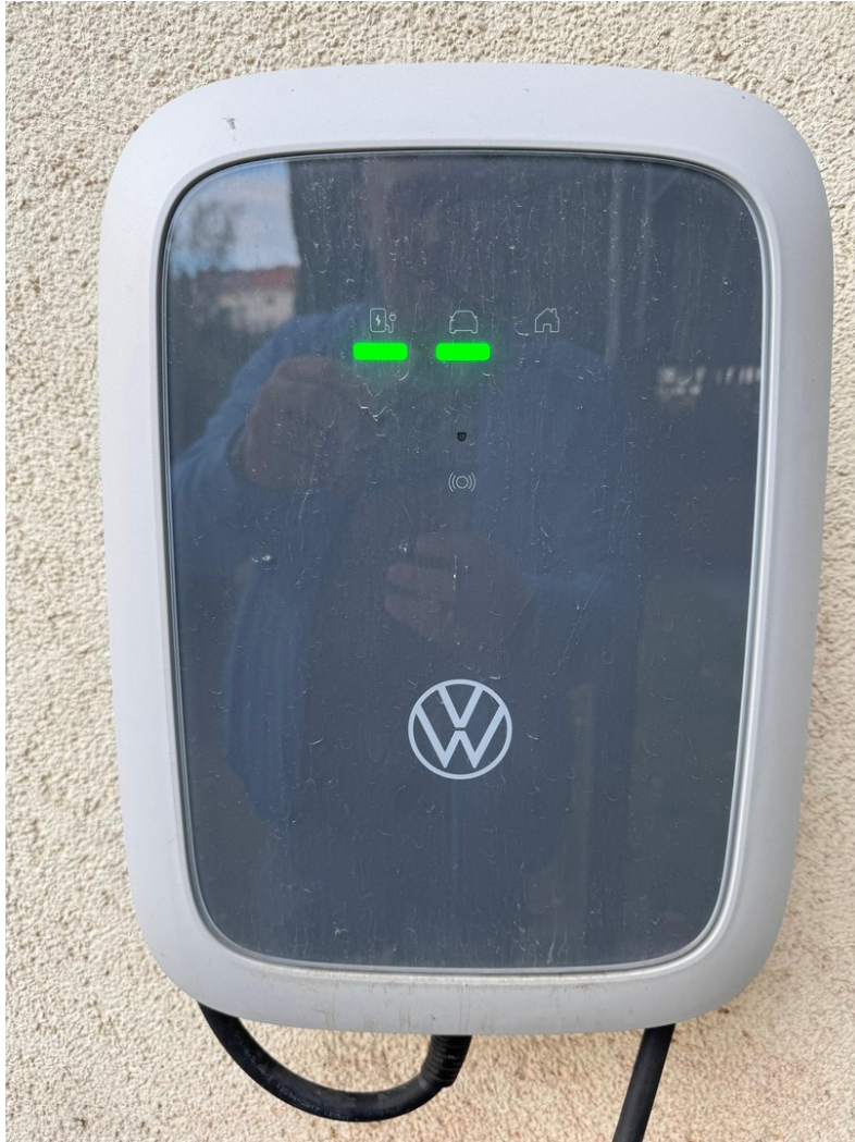
Ladesäule für eAuto
